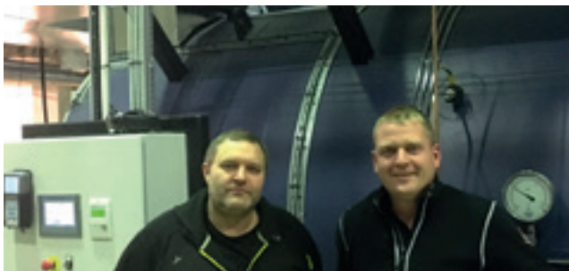
Bengt Pettersson och Fredrik Hamberg på Falkenberg Energi visar nya värme pannan som tryggar leveranserna till fjärrvärmekunderna i Falkenberg.
